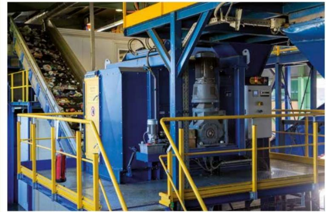
1. Boca de alimentación del abrebolsas.
