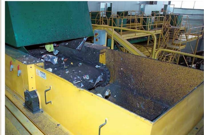
1. Separador de Inducción.
